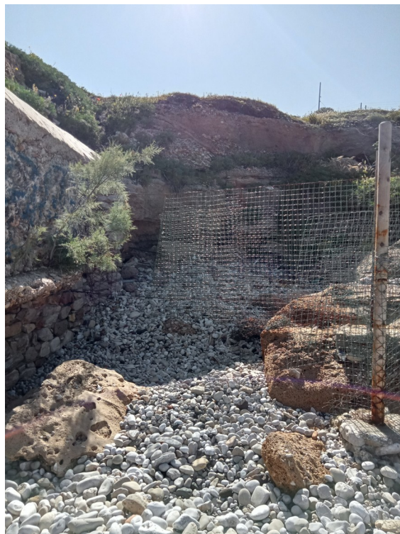
Domage clôture - accès mer
