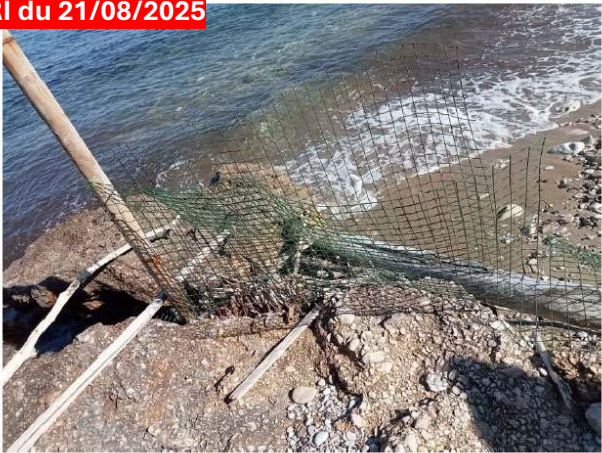
Barrière détruite – accès plage Sud
