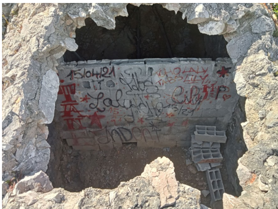
mise en sécurité de la cheminée rampante suite à des dégradations
