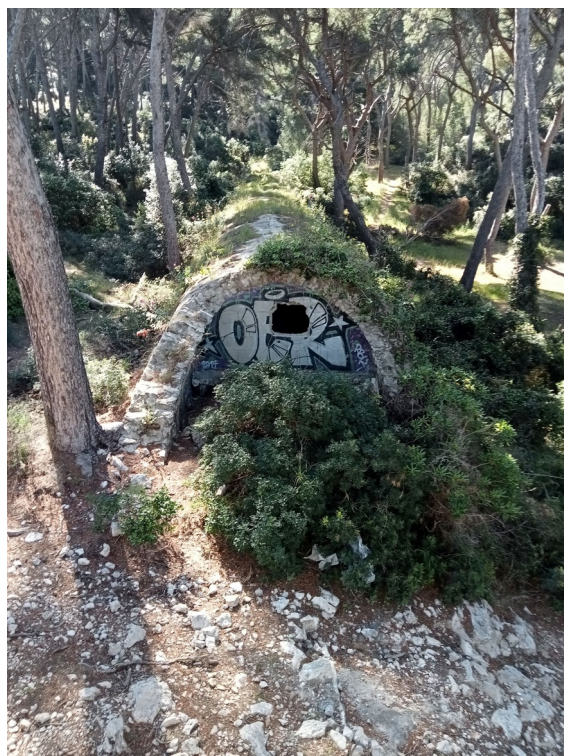
cheminée rampante partiellement en sécurité
